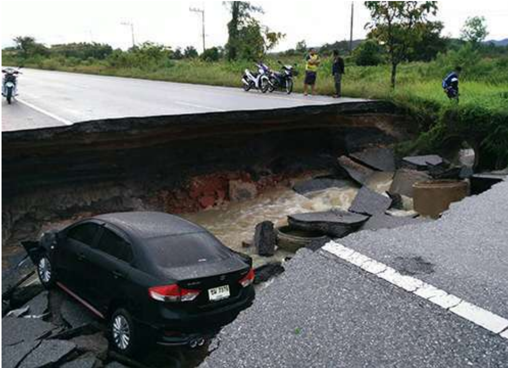
รูปที่ 5.3-1 ความเสียหายบนหลวงหมายเลข 43 บริเวณ บ้านเขาน้อย ตำบลสะกอม อำเภอเทพา จังหวัดสงขลาเมื่อ วันที่ 30 พฤศจิกายน พ.ศ. 2560
